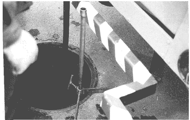
写真 13 高圧ホースと人孔蓋の関係
