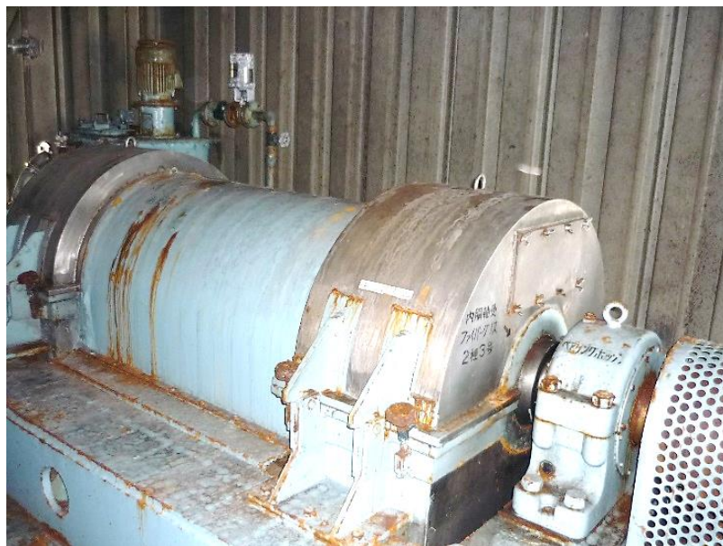
写真 2 此花処理場の遠心脱水機 20 m 3 /hr
