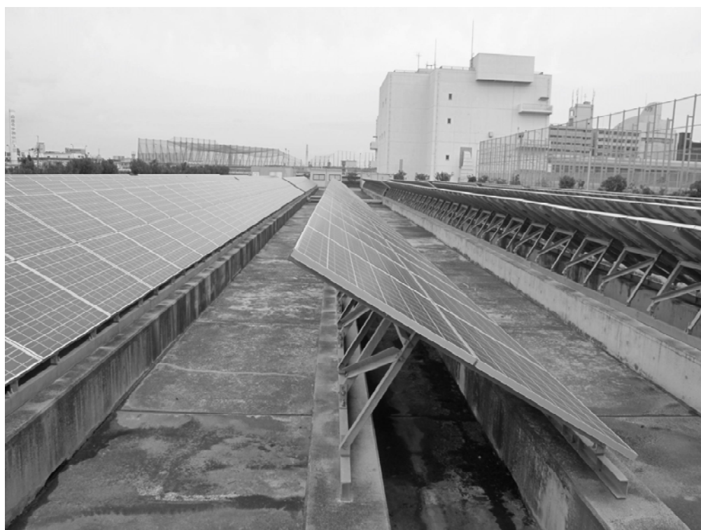
下水処理場の太陽光発電
